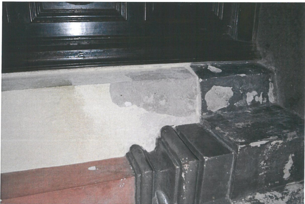
Fot.19 i 20. Legnica, kościół p.w. Św. Jana Chrzciciela. Stan przed konserwacją. Fot. K. Samborski, listopad 2020r.
