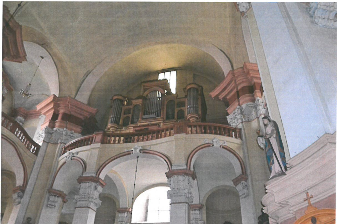
Fot.5 i 6. Legnica, kościół p.w. Św. Jana Chrzciciela. Stan przed konserwacją. Widoczne podstemplowanie osiadającego sklepienia jednej z kaplic. Fot. K. Samborski, listopad 2020r.
