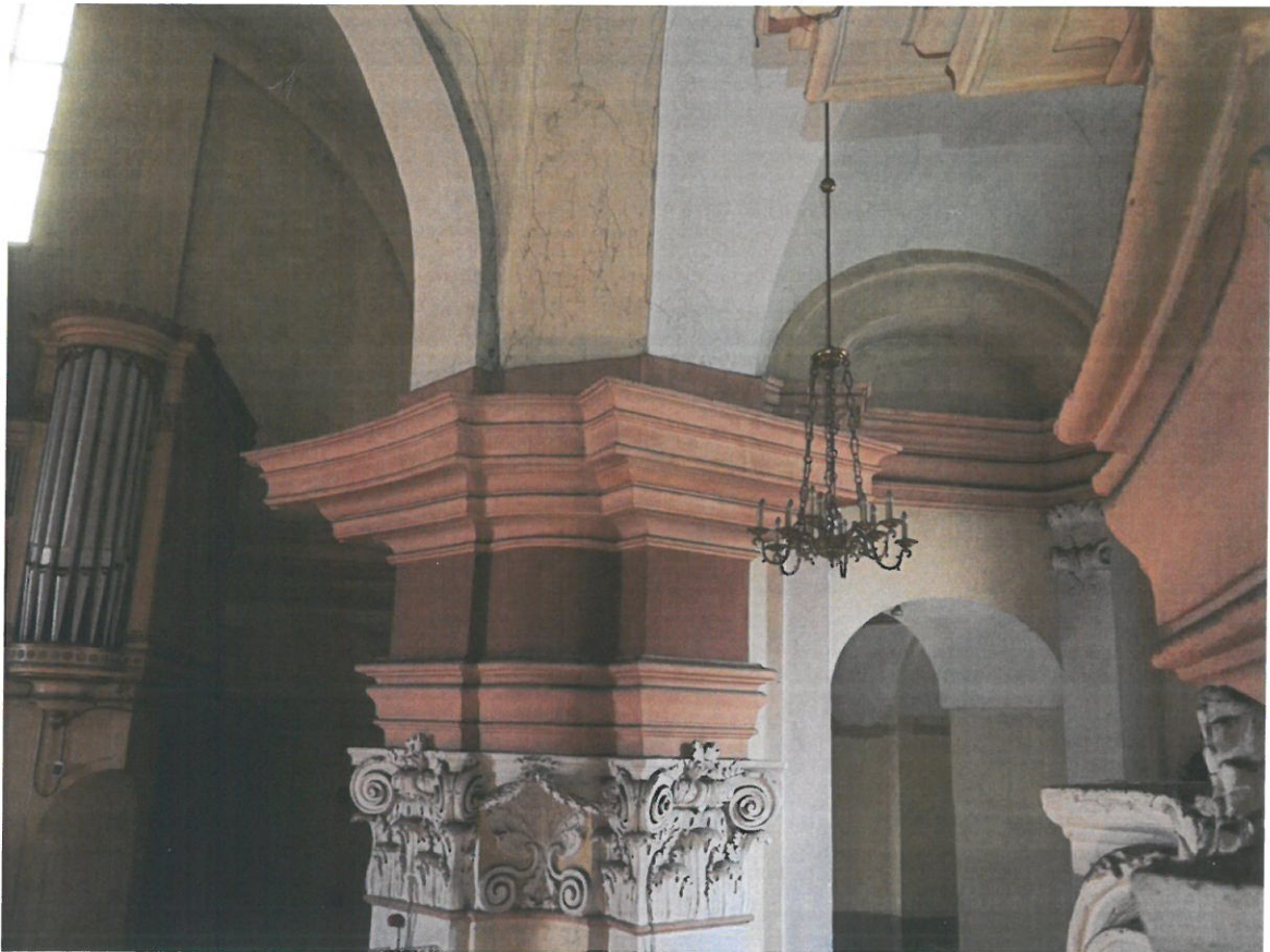
Fot.9 i 10. Legnica, kościół p.w. Św. Jana Chrzciciela. Stan przed konserwacją. Widoczne spękania i zarysowania na sklepieniu. Fot. K. Samborski, listopad 2020r.
