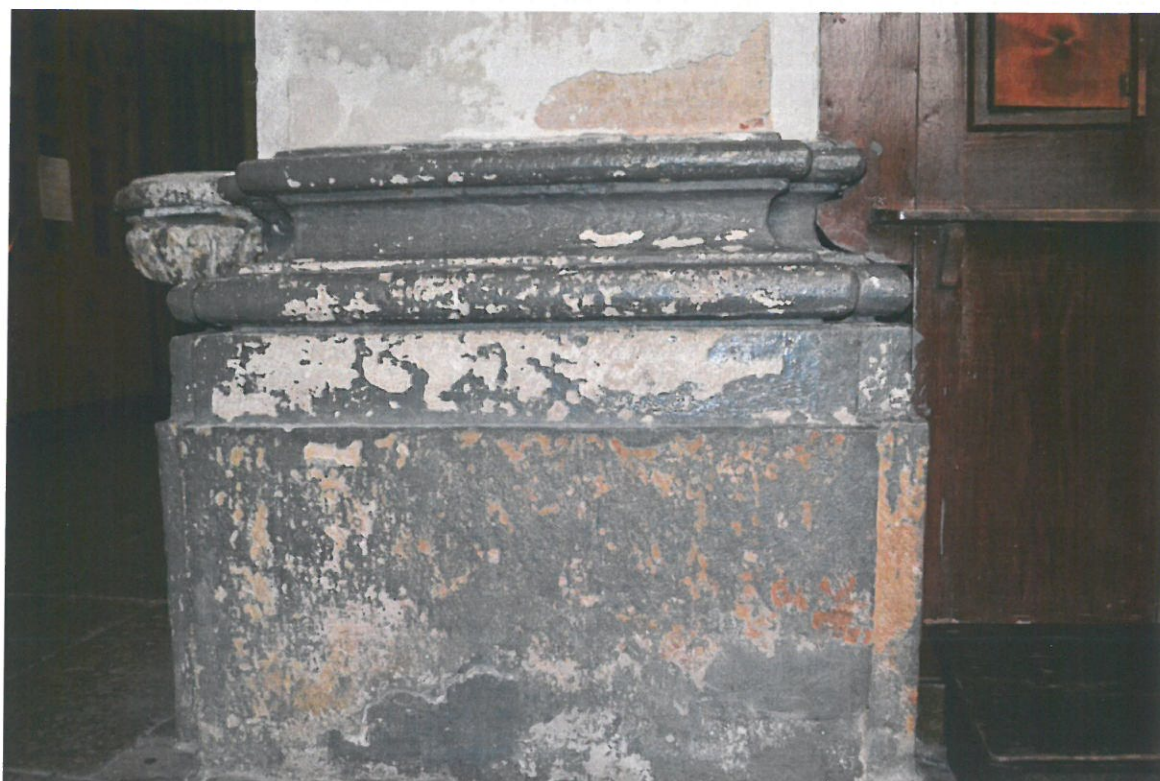
Fot.17 i 18. Legnica, kościół p.w. Św. Jana Chrzciciela. Stan przed konserwacją. Widoczne znaczne zawilgocenie i zasolenie dolnych partii ścian, ubytki tynku, cokół z piaskowca wtórnie pomalowany farbami olejnymi. Fot. K. Samborski, listopad 2020r.
