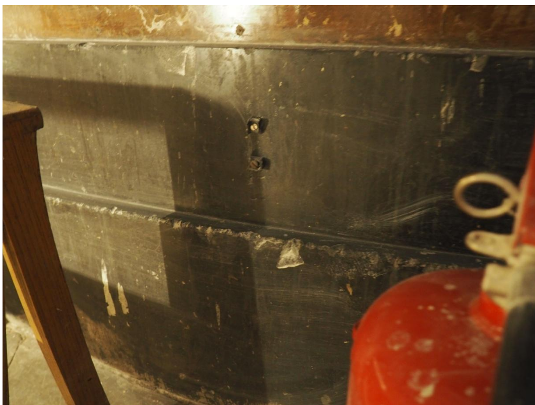
Il. 14. Ołtarz główny w kościele p.w. św. Jana Chrzciciela w Legnicy. Od odwrocia ołtarza widoczne są liczne mechaniczne uszkodzenia stiukowej okładziny. Fot. K. Samborski, 2022 r.
