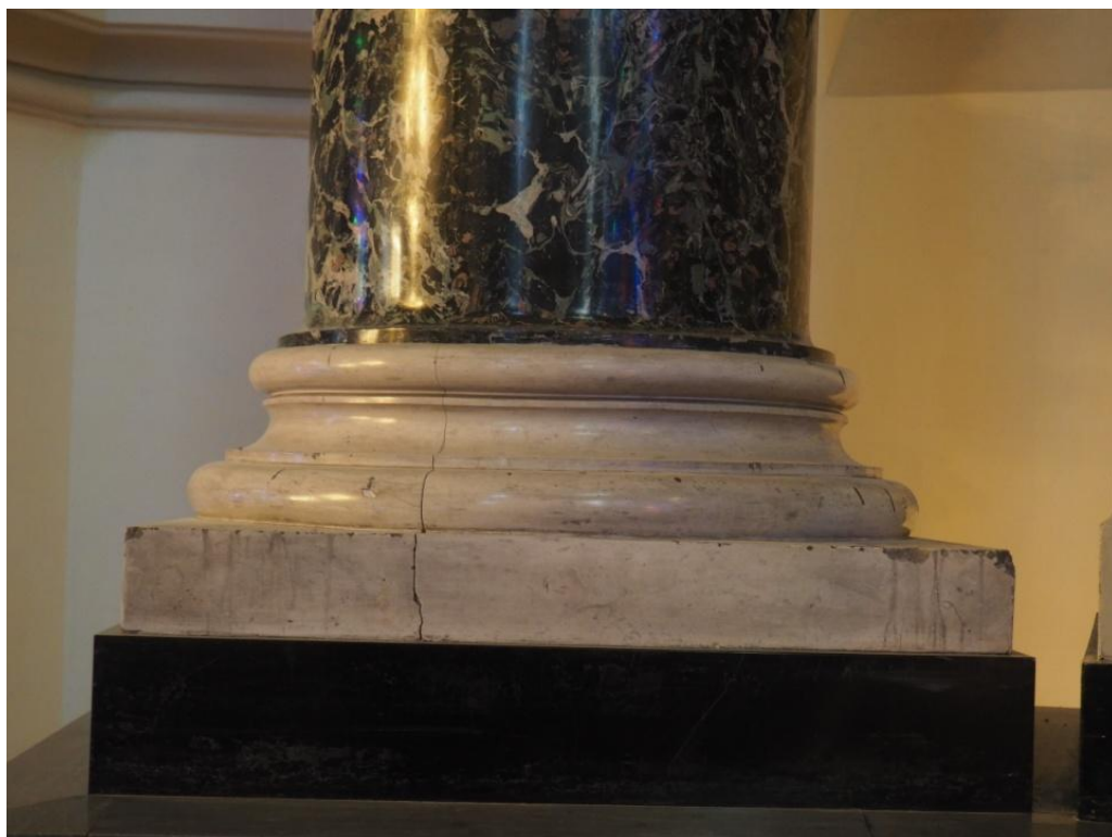
Il. 13. Ołtarz główny w kościele p.w. św. Jana Chrzciciela w Legnicy. W obrębie stiukowych /?/ baz kolumn widoczne są pęknięcia, zabrudzenia i zacieki. Fot. K. Samborski, 2022 r.
