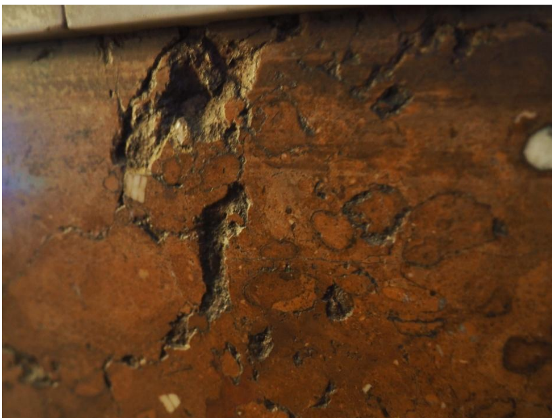
Il. 12. Ołtarz główny w kościele p.w. św. Jana Chrzciciela w Legnicy. Na płytach marmurowych widoczne są ubytki w postaci soczewkowatych form. Fot. K. Samborski, 2022 r.
