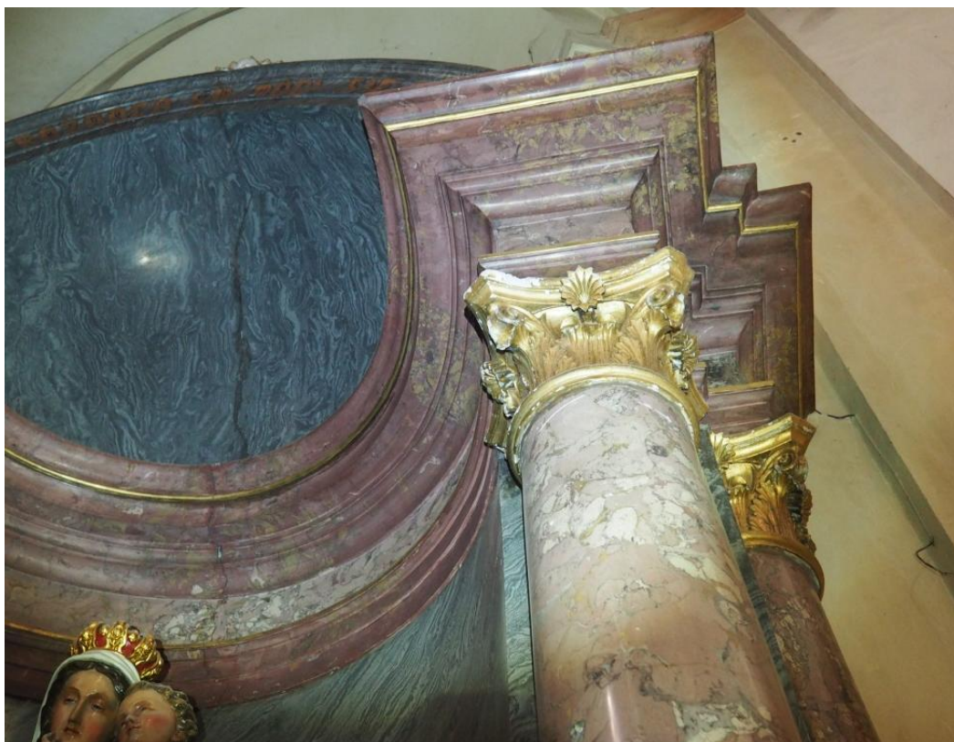
Il. 25. Ołtarz boczny p.w. NMP w kościele p.w. św. Jana Chrzciciela w Legnicy. Widoczne pęknięcie w górnej części retabulum oraz ubytki na krawędzi kapitelu kolumny. Fot. K. Samborski, 2022r.
